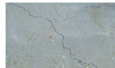
Typische Fröhschwindrisse infolge vorzeitiger Austrocknung einer Betondecke
